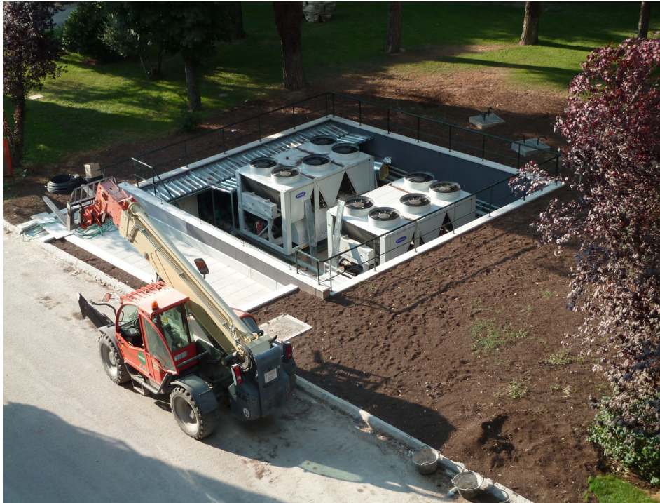
Groupes de la climatisation
