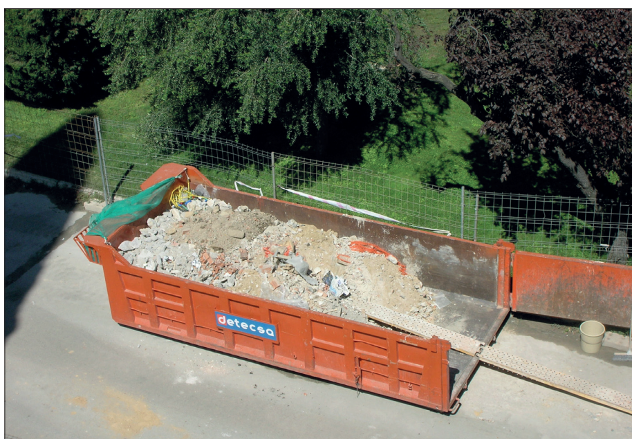
Plus de 100 bennes remplies de gravats ont été évacuées en quatre mois, soit 1 200 m 3
